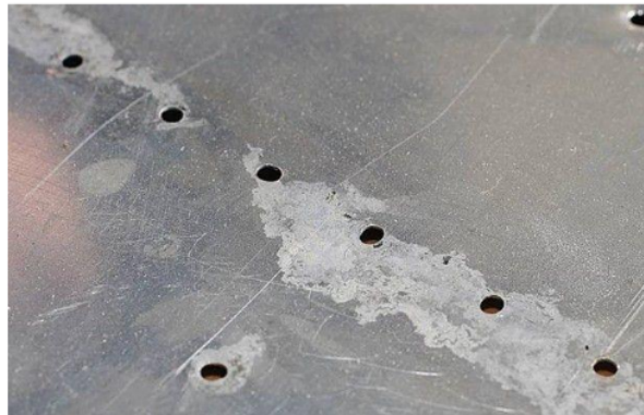
Gambar 3.15 Korosi Pada Permukaan
